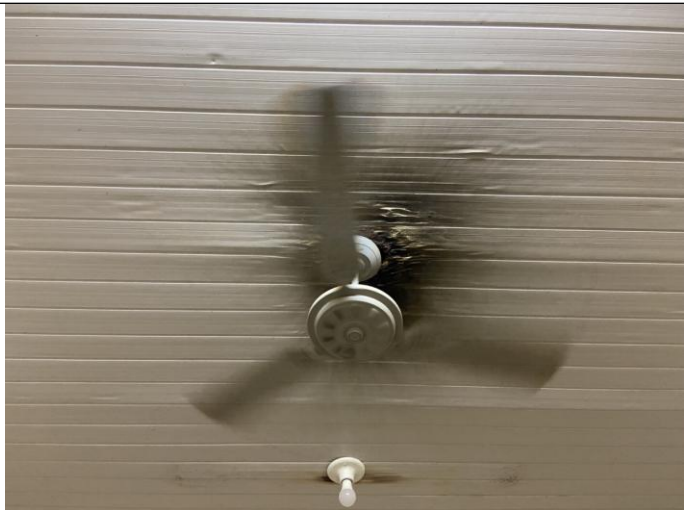
Figura 11 - Princípio de incêndio no ventilador
