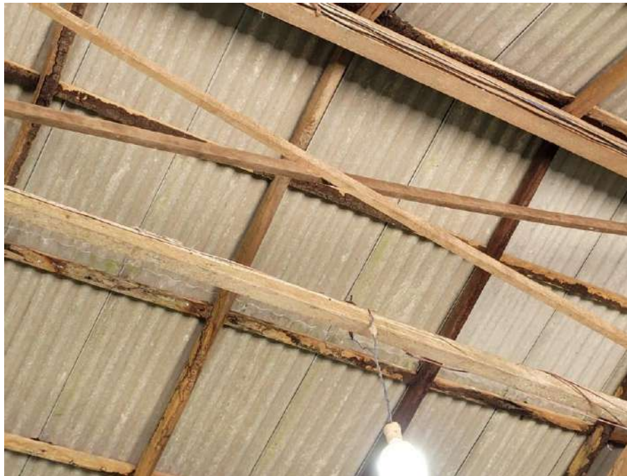
FOTOGRAFIA 7 - COBERTURA A RECUPERAR
