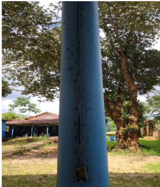
FOTOGRAFIA 18 - ESTRUTURA A RECUPERAR
