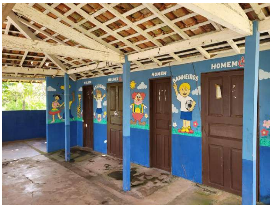
FOTOGRAFIA 15 – BANHEIROS A REFORMAR
