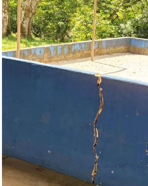
FOTOGRAFIA 16 - MURETA A RECUPERAR
