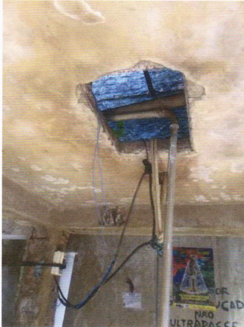
CASA DE BOMBAS
